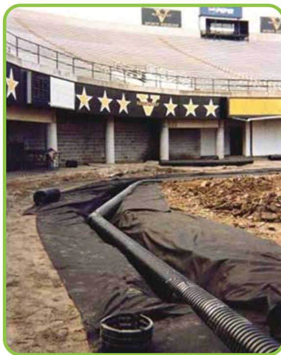
Les géotextiles enveloppent les tuyaux et le remblai de pierre angulaire afin de prévenir l'intrusion du sol dans le remblai ou l'aire de stockage de l'eau.
