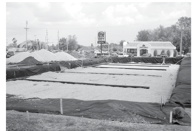
Placez une assise en pierre nette, angulaire et concassée d'une épaisseur minimale de 230mm (9po). Installez le drain si nécessaire. Compactez pour obtenir une surface plane.
