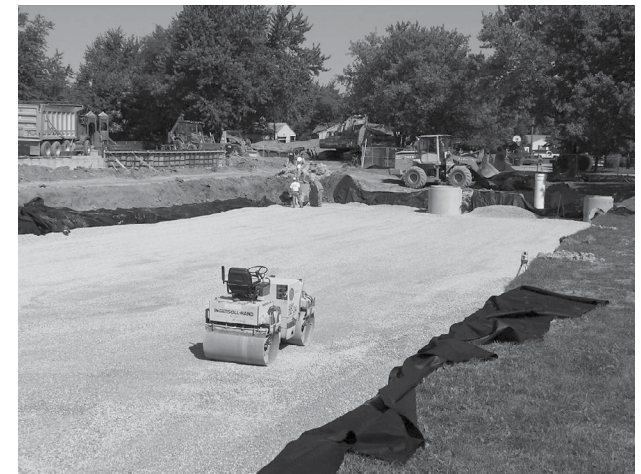
Placez une assise en pierre nette, angulaire et concassée d'une épaisseur minimale de 150mm (6po). Compactez pour obtenir une surface plane.
